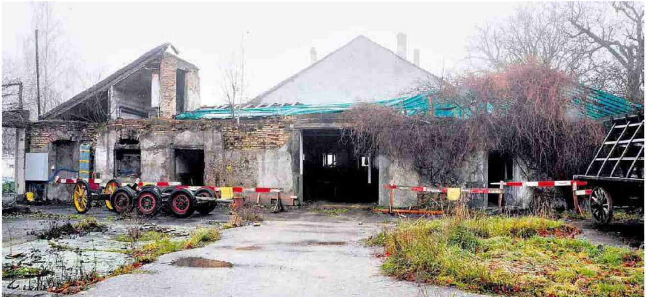
Die Brandruine auf dem Klosterareal Rheinau ist einsturzgefährdet und soll deshalb für rund 135 000 Franken bis Mitte dieses Jahres rückgebaut werden. Bild: Marc Dahinden
